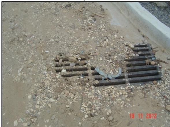
Figura 31 – Boca de lobo com problemas de limpeza
